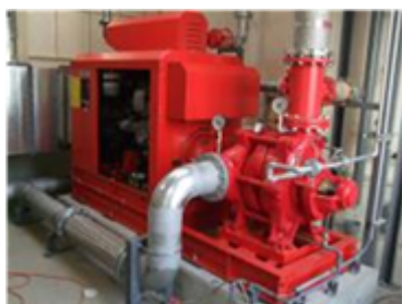
非常用動力装置
