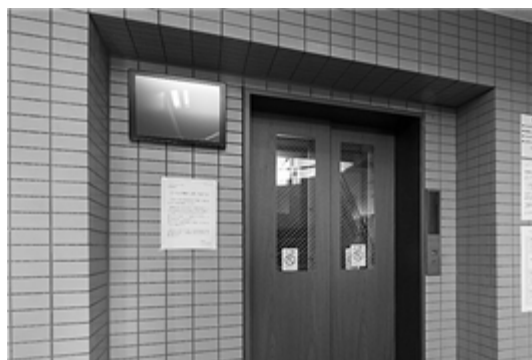
<エレベーター>
