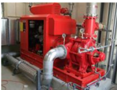
非常用動力装置
