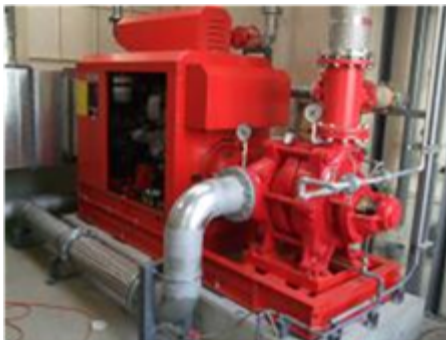
非常用動力装置
