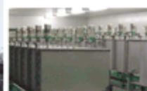
溶媒抽出装置
