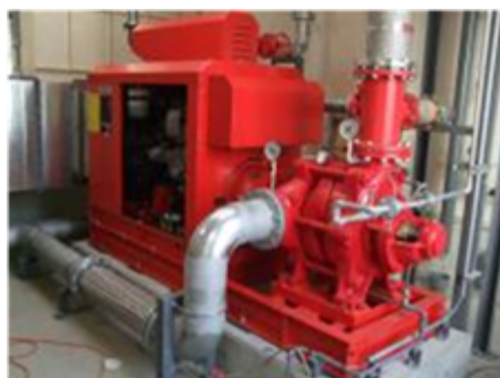
非常用動力装置
