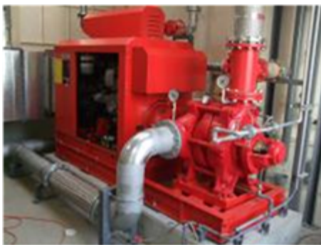
非常用動力装置
