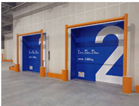
荷物用大型エレベーターの設置例
