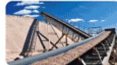
運搬距離の長いベルトコンベヤ設備
