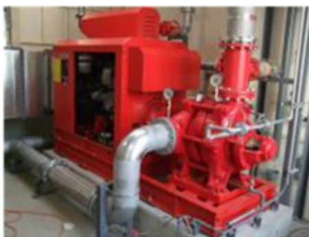
非常用動力装置
