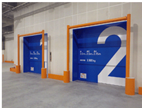
荷物用大型エレベーターの設置例
