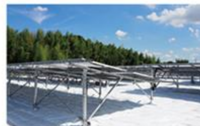
栃木 河内郡上三川町発電所 両面パネルへの入替え・反射シートの設置後
