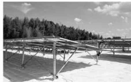
栃木 河内郡上三川町発電所 両面パネルへの入替え・反射シートの設置後
