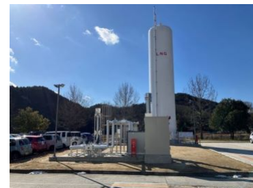
ボイラLNG設備(京都工場)
