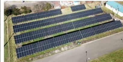
太陽光発電設備（磯分内工場）
