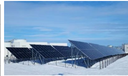
太陽光発電設備（大樹工場）
