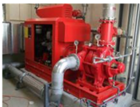
非常動力装置
